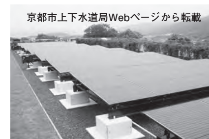
図4 蹴上浄水場の太陽光発電設備
